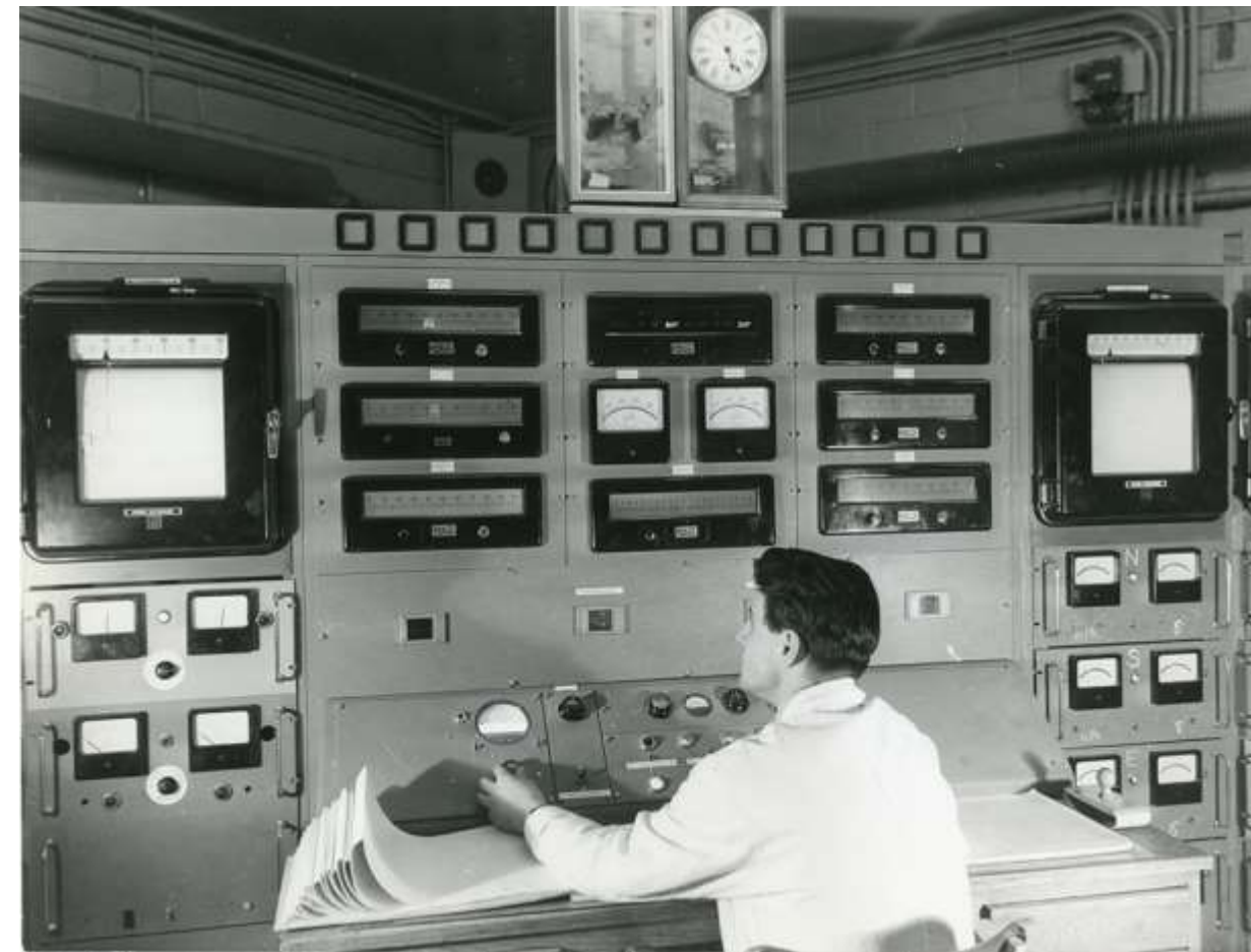
1955 – Tableau de commande de la pile Zoé
