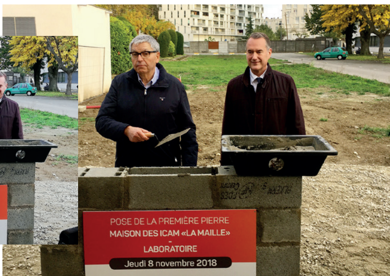
Pierre-Yves Rogez, Président de la Fondation Féron-Vrau et Luc Laventure, Directeur Général de Toulouse Métropole Habitat, posant la première pierre du projet commun Ecole et résidence étudiante du campus Icam Toulouse
